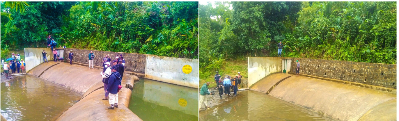
▷ 29 Juin 2021 : Inauguration des travaux d'aménagement du barrage de Sahanofia, Région Analanjirofo par le MAEP à travers le projet PADAP
